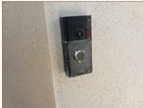
Inoperable door bell
