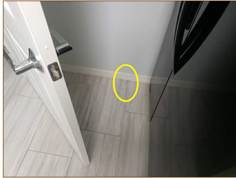
Missing door stop(s)
